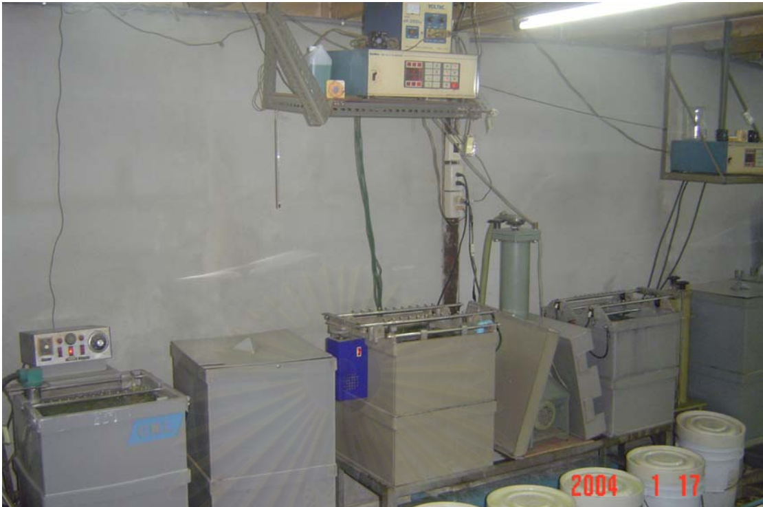
รูปที่ ก-1 ถังชုပ် , ถังล้างและอุปกรณ์ชุดจ่ายไฟฟ้ากระแสตรง
