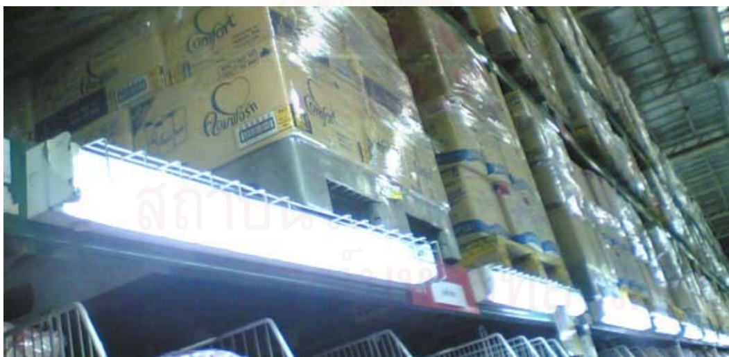
รูปที่ 25 จำลองโครงการติดไฟในบริเวณจัดเก็บบรรจุภัณฑ์
