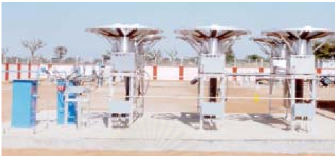
รูปที่ 2.17 สถานีผลิตไฟฟ้า (Power station) ด้วยเซลล์ความร้อนโดยใช้แหล่งความร้อนจากการเผาแก๊ส เพื่อใช้ในบริเวณที่ไฟฟ้าเข้าไม่ถึง
