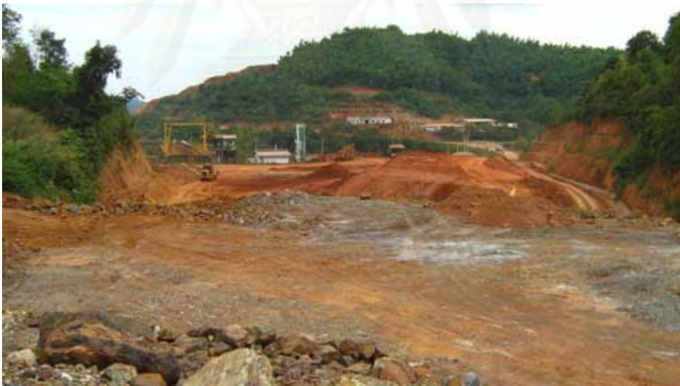
รูปที่ 4.2 ลานกองสินแร่ (ROM Pad) จากหน้าเหมืองก่อนป้อนเข้าสู่กระบวนการแต่งแร่ (24 พฤศจิกายน 2551)
