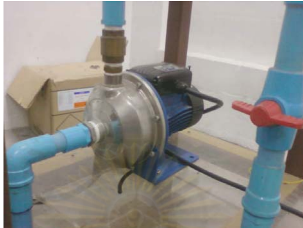
รูปที่ ก-3 ปั๊มน้ำ
