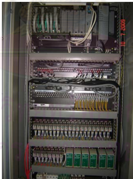
รูปที่ ก-6 ตู้ควบคุมเครื่อง DCS
