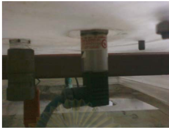
รูปที่ ก-9 การติดตั้งของบอลวาล์วและเซ็นเซอร์ใต้ถังของชุดทดลอง
