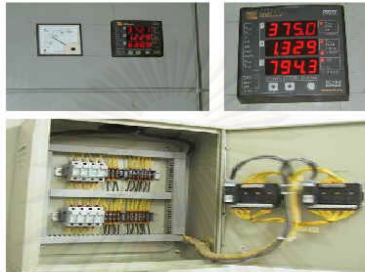
ภาพที่ 3-8 แสดงภาพการเชื่อมต่อโครงข่ายอุปกรณ์การจับเก็บข้อมูลการตรวจวัดน้ำเย็นในระบบทำความเย็น
