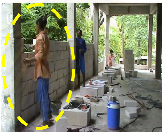
รูปที่ 4.17 แสดงการก่ออิฐที่อยู่ในระดับหน้าอก ซึ่งคนงานยื่นก้ออิฐได้ปกติ (กลุ่มข้อมูล 1 รหัสท่าทาง 1121 ระดับความอันตราย 1)
