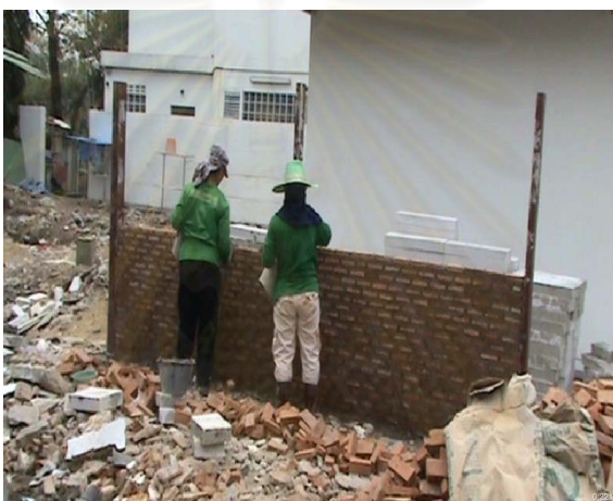
รูปที่ 5.40 แสดงการก่ออิฐมอญที่ระดับความสูงระดับหน้าอก คนงานยืนก่ออิฐได้ปกติ
