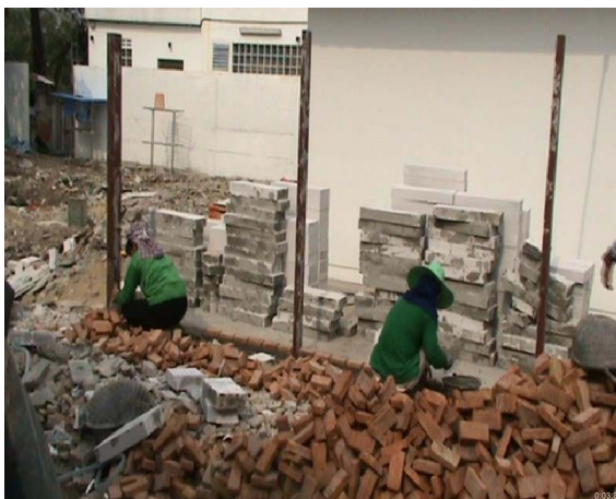
รูปที่ 5.39 แสดงสภาพการก่ออิฐมอญที่ระดับความสูงต่ำ คนงานต้องนั่งยอง หรือต้องก้ม
