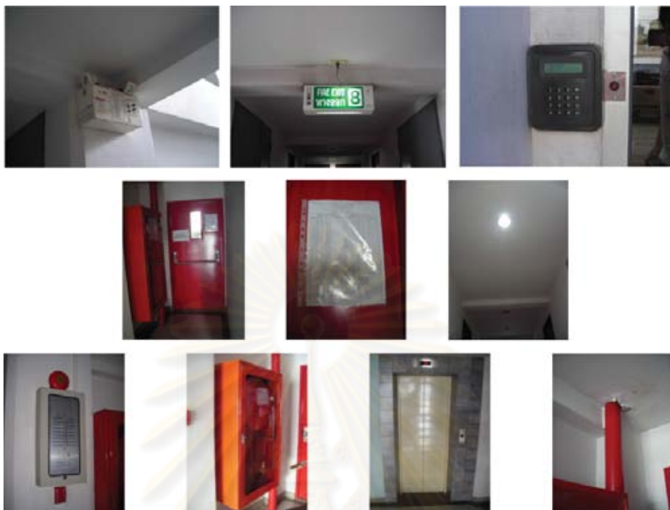
ภาพที่ 3.35 แสดงตัวอย่างลักษณะระบบประกอบอาคารทุกอาคารของ
