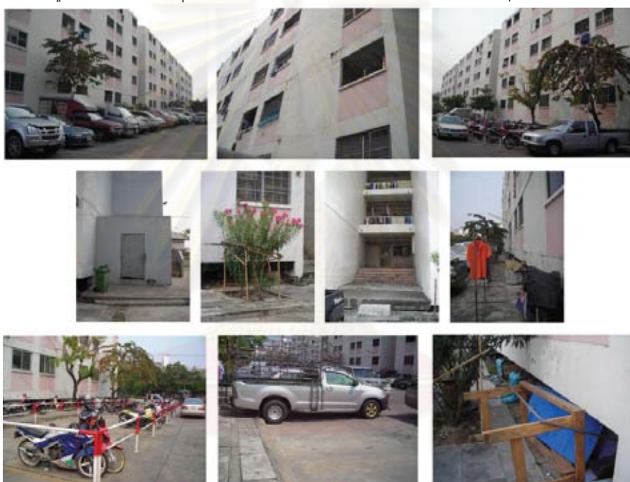
ภาพที่ 3.9 แสดงตัวอย่างสภาพภายนอกบริเวณอาคาร 1-2 ของนิติบุคคลอาคารชุดเคหะชุมชนธนบุรี 3
