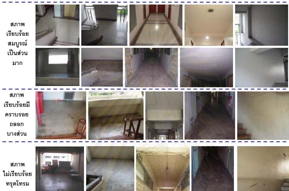
ภาพที่ 4.3 สรุปสภาพทางกายภาพภายในที่พบ
