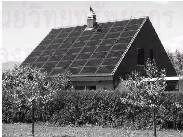
รูปที่ 2.1 เซลล์สุริยะติดบนหลังคาบ้าน
