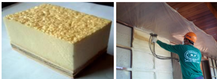
ภาพที่ 2.12 ฉนวนโพลียูรีเทนโฟม และภาพการฉีดพ่นฉนวนโฟมที่ผนัง
