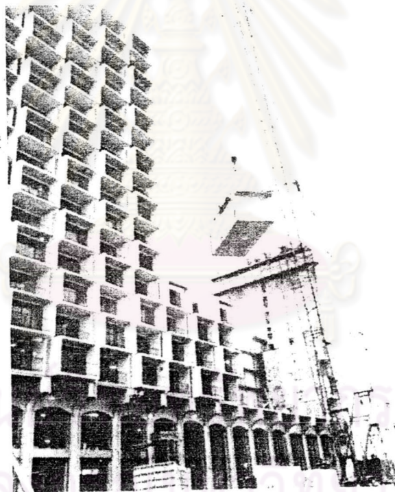
ภาพ 2.7 การก่อสร้างระบบกล่อง (ที่มา : Design of Concrete Structures, 2545) 16
