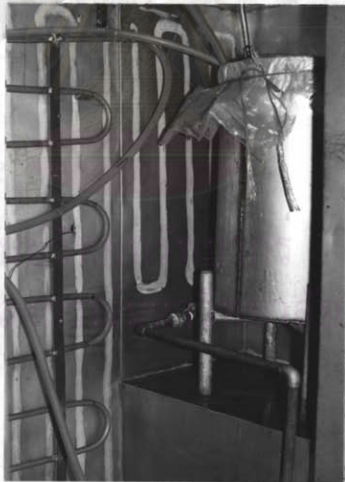
รูปที่ 3.12 หน่วยทำน้ำหล่อเย็น
