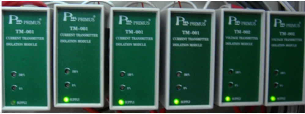
VIII. อุปกรณ์แปลงกระแสไฟฟ้าและแรงดันไฟฟ้า
