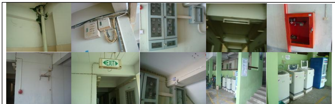
รูปภาพที่ 3.37 ลักษณะกายภาพระบบประกอบอาคาร 14-16
