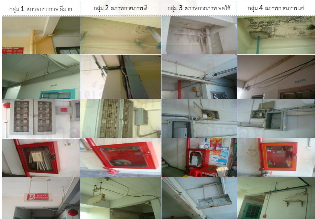
รูป.3 ลักษณะระบบประกอบอาคารที่แตกต่างกัน
