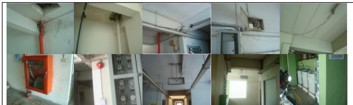
รูปภาพที่ 3.46 ลักษณะกายภาพระบบประกอบอาคาร 22-23
