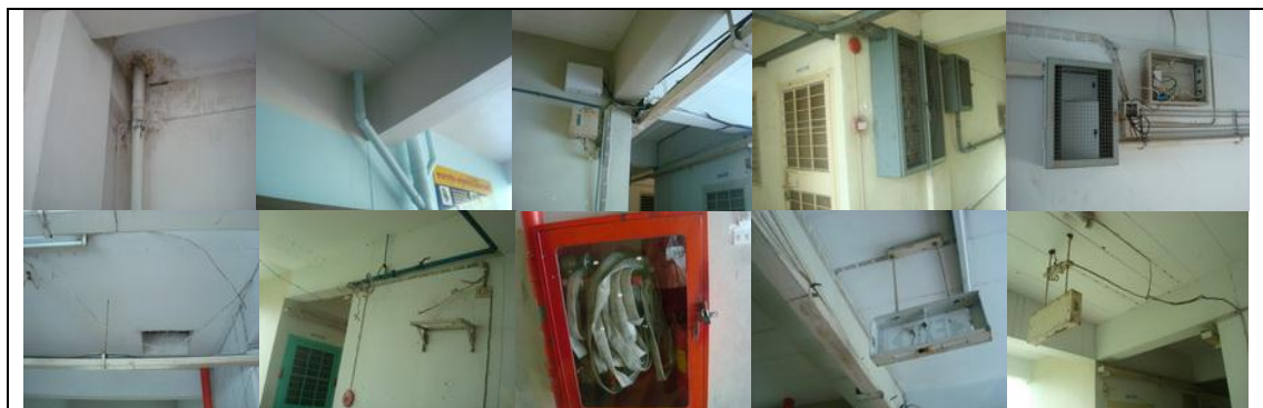
รูปภาพที่ 3.28 ลักษณะกายภาพระบบประกอบอาคาร 12-13
