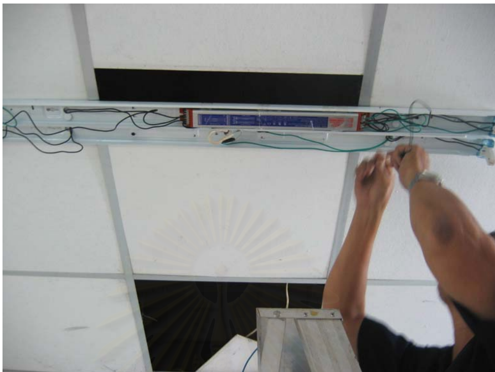
ภาพที่ 3.2 แสดงชุดรางนีออนสำเร็จรูปขนาด และอุปกรณ์ ชุด Analog Dimming Ballast
