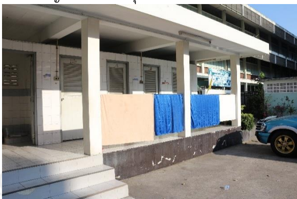
ภาพที่ 4.8 ห้องน้ำใช้วัสดุพื้นผิวเป็นกระเบื้องที่ลื่น
