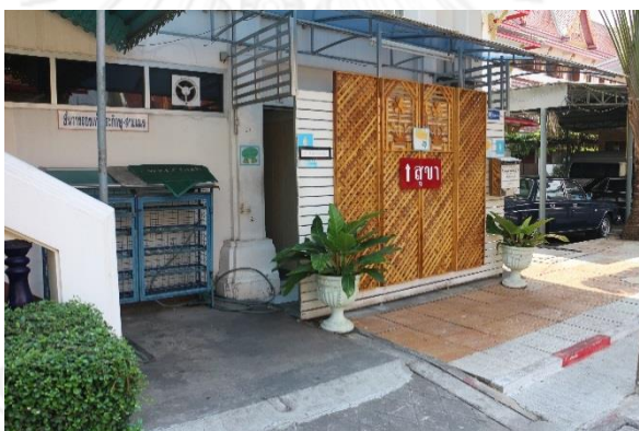
ภาพที่ 4.33 พื้นผิวทางเดินมีความต่างระดับเสี่ยงต่อการสะดุดหกล้ม
