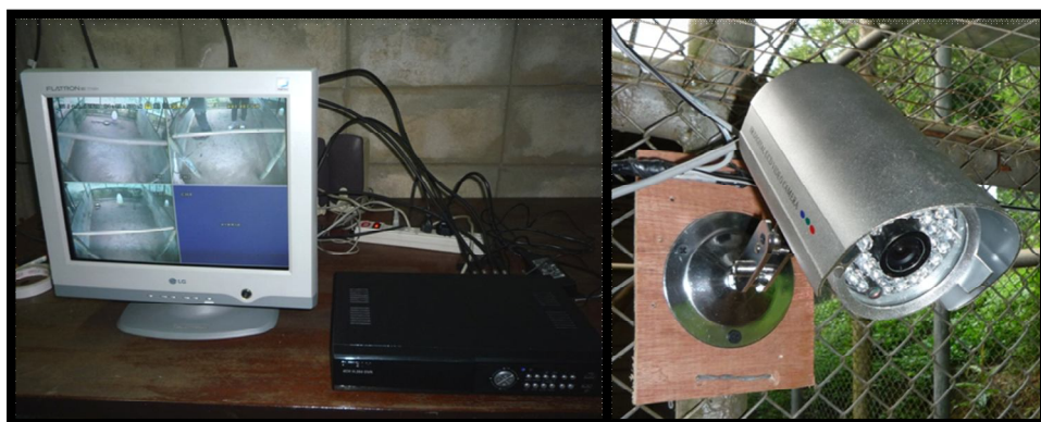
ภาพที่ 3.8 จอคอมพิวเตอร์และเครื่องบันทึก (ซ้าย) กล้องวงจรปิดแบบอินฟราเรด (ขวา)
