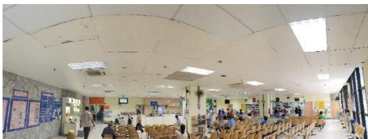
ภาพที่ 4.85 สภาพฝ้าเพดานของพื้นที่พักรอตรวจ
