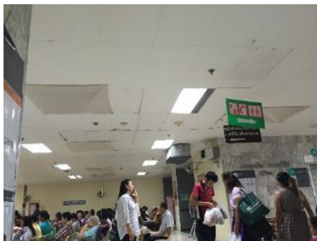
ภาพที่ 4.40 สภาพฝ้าเพดานของพื้นที่พักรอตรวจ
