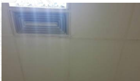
ภาพที่ 4.41 สภาพฝ้าเพดานของพื้นที่พักรอตรวจ
