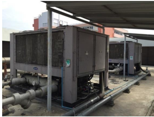
รูป ข.3 เครื่องทำน้ำเย็นชนิดระบายความร้อนด้วยอากาศที่ทำการตรวจวัด
