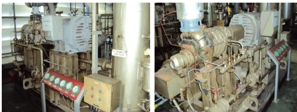
รูปที่ 4- 17 COMPRESSOR ขนาด 200 กิโลวัตต์ ชนิด SCREW 2 STAGE ของ MYCOM
