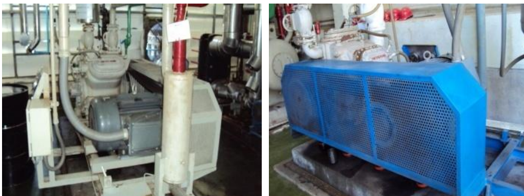
รูปที่ 4- 16 COMPRESSOR (AIR FILLETING) ขนาด 75 กิโลวัตต์ ชนิด RECIPROCATING ของ MYCOM
