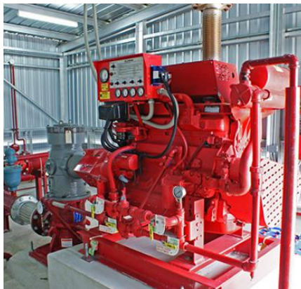
รูปภาพที่ 3. 25 แสดงระบบปุ่มดับเพลิง
