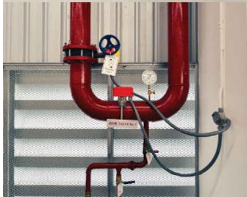
รูปภาพที่ 3. 23 แสดงระบบระบบดับเพลิงแบบสปริงเกอร์ ภายในอาคารคลังสินค้าของโครงการ ที่พาร์ค
