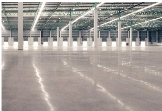
รูปภาพที่ 3. 7 แสดงพื้นอาคารคลังสินค้าของโครงการ ทีพาร์ค
