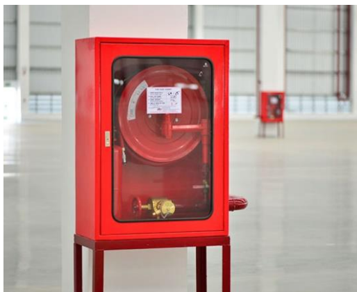
รูปภาพที่ 3. 26 อุปกรณ์ดับเพลิง ภายในอาคารคลังสินค้าของโครงการ ทีพาร์ค
