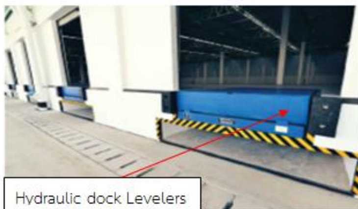
รูปภาพที่ 5. 22 Hydraulic dock Levelers (อุปกรณ์ช่วยในการลำเลียงสินค้า เข้า-ออก คลังสินค้า)
