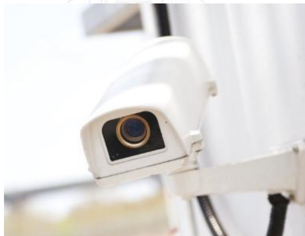
รูปภาพที่ 3. 5 แสดงระบบ CCTV ในโครงการฯ
