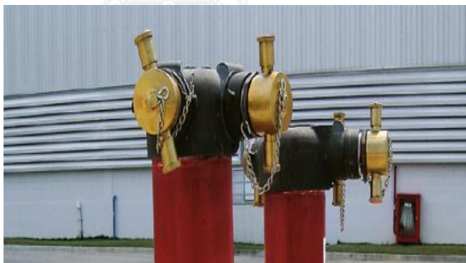
รูปภาพที่ 3. 3 แสดงระบบการป้องกันอัคคีภัยในโครงการ ที่พาร์ค
