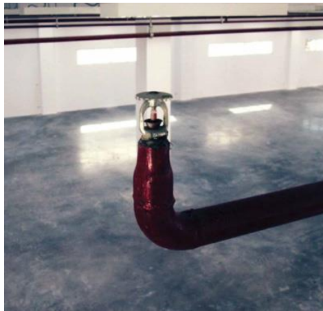
รูปภาพที่ 3. 24 แสดงระบบระบบดับเพลิงแบบสปริงเกอร์ ภายในอาคารคลังสินค้าของโครงการ ที่พาร์ค
