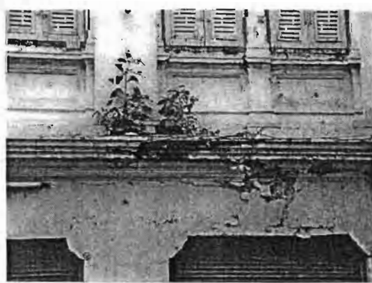
ภาพที่ 33 ความเสียหายของปูนปั้นและ ลวดบัวบริเวณผนังด้านหน้าอาคาร
