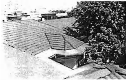
ภาพที่ 13 หลังคาของอาคารกรมโยธาธิการก่อนการบูรณะ
