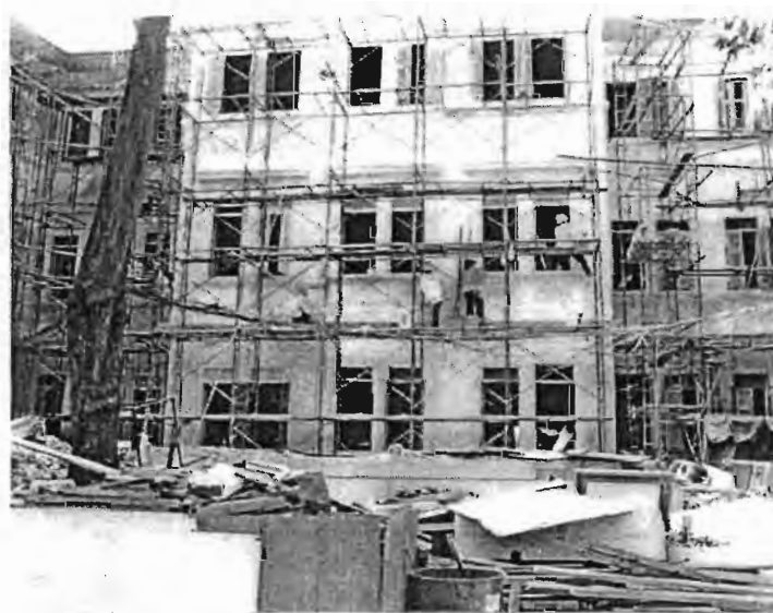
ภาพที่ 51 ผนังด้านหลังอาคารระหว่างการฉาบผิวภายนอกใหม่ทั้งหมด
