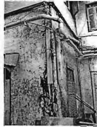
ภาพที่ 18 ความเสียหายของผนังอาคาร เนื่องจากความชื้นและน้ำฝน
