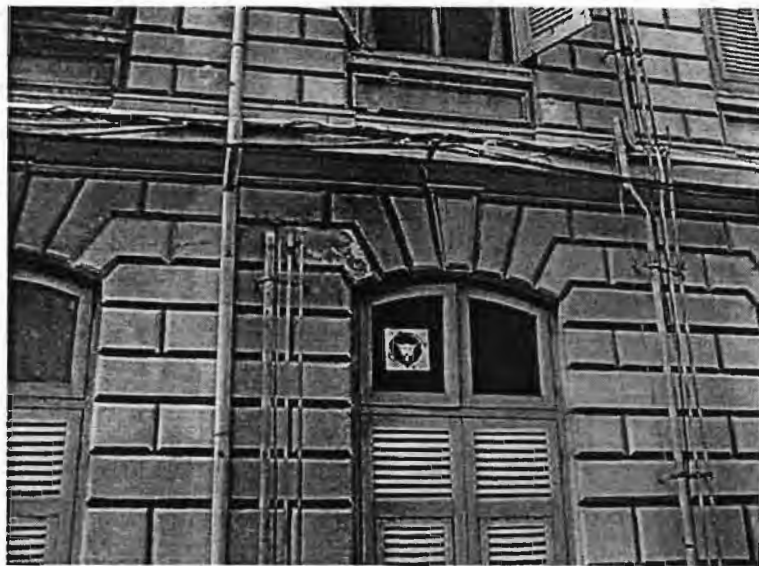
ภาพที่ 89 ผนังอาคารภายนอกที่ฉาบด้วยซีเมนต์ผสมน้ำยากันซึม
