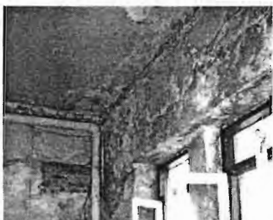
ภาพที่ 26 ความเสียหายของฝ้าเพดานจากการรั่วซึมของน้ำจากระบบสุขาภิบาล
