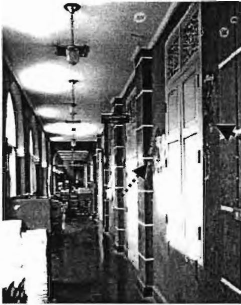
ภาพที่ 81 ความเสียหายของผนังอันเนื่องมาจากความชื้นใต้ดินปรากฏบนผนังทุกส่วนของอาคาร
