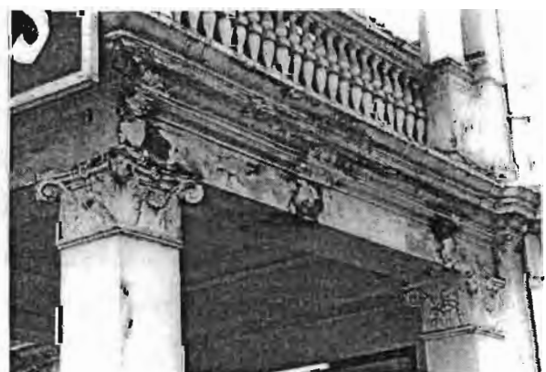
ภาพที่ 34 ความเสียหายของปูนปั้นและ ลวดบัวบริเวณระเบียงเหนือทางเข้าด้านหน้าอาคาร
