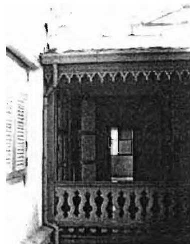
ภาพที่ 119 หลังคาสวนต่อเดิมและรางน้ำ ของศาลาลูกขุนในพระบรมมหาราชวัง
