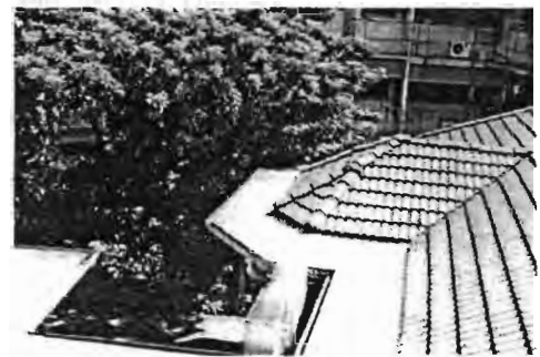
ภาพที่ 14 รางน้ำของอาคารกรมโยธาธิการก่อนการบูรณะ
