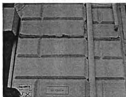
ภาพที่ 133 การหลุดร่อนของสีที่ทาผนังเนื่องจาก ความชื้น
