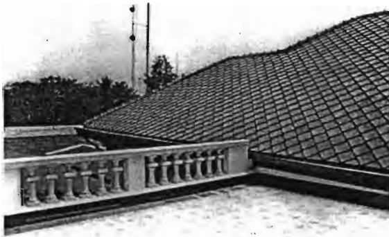
ภาพที่ 103 หลังคาตำนกสวนป่ารุกข์วัน ใช้กระเบื้องซีเมนต์รูปสี่เหลี่ยม รูป วัว สีแดง ในการบูรณะอาคาร
