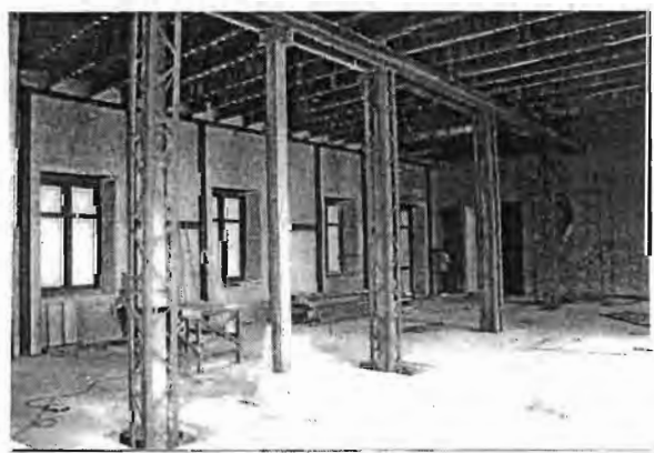
ภาพที่ 158 การเสริมเหล็กรูปพรรณบริเวณผนังเพื่อกระจายการรับน้ำหนักของชั้น 2 ศาลาว่าการกระทรวงกลาโหม
