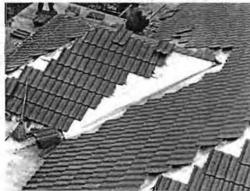
ภาพที่ 45 การปูแผ่นสะท้อนความร้อนก่อนมุงทับด้วยกระเบื้องซีเมนต์
