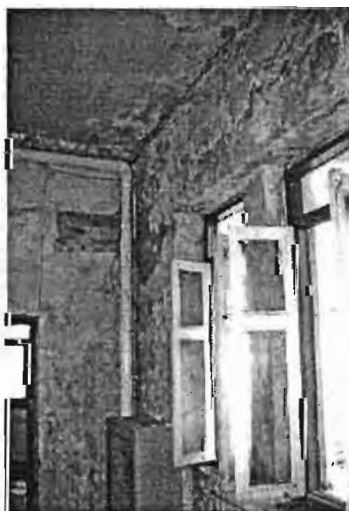
ภาพที่ 19 ผนังภายในของอาคารที่ได้รับความเสียหายจากความชื้น
