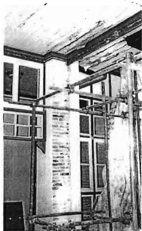
ภาพที่ 74 ความเสียหายของฝ้าเพดานและผนังเนื่องจากความชื้นจากน้ำฝน
