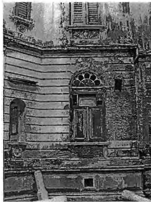
ภาพที่ 123 ผนังของอาคารที่ได้รับความเสียหายจากความชื้น
