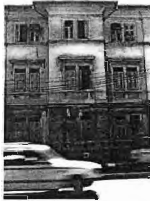
ภาพที่ 17 ผนังด้านข้างอาคาร 3 ชั้น ด้านถนน หลวงก่อนการบูรณะ มีคราบเขม่าจากควีนรถเกาะอยู่อย่างเห็นได้ชัด
