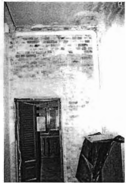
ภาพที่ 50 ผนังก่ออิฐภายในที่เสียหายจากน้ำรั่วการบูรณะทำควบคู่ไปกับการปรับปรุงระบบสุขาภิบาล
