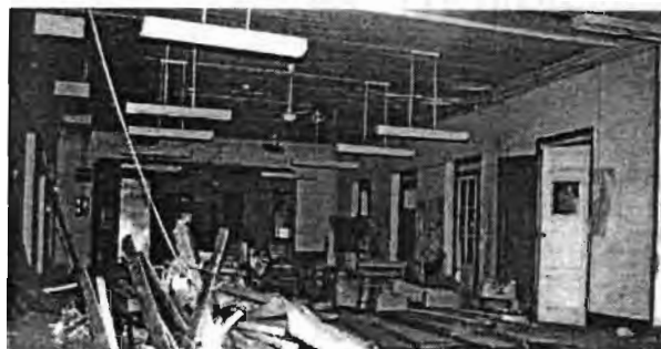
ภาพที่ 27 ฝ้าเพดานและผนังภายในของอาคารก่อนการบูรณะ
