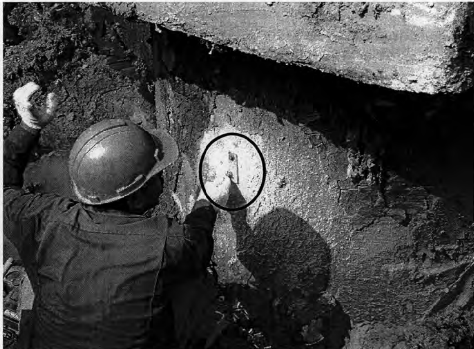
รูปที่ ก.8 การติดตั้ง Strain transducer และ Accelerometer
