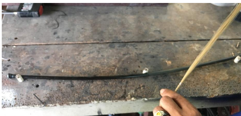
ภาพที่ 4.94 คั้นซีกตัดให้โค้งตามสลักที่ตอกไว้
