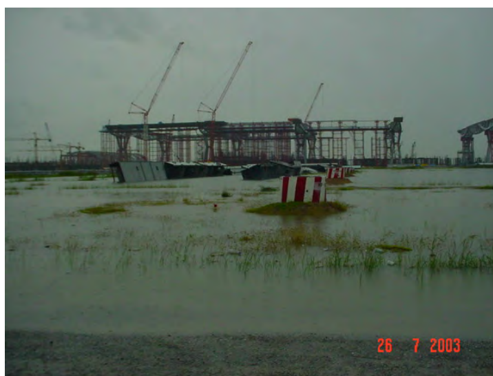
รูปที่ 9.2 แสดงน้ำท่วมอาคารผู้โดยสารและอาคารเทียบเครื่องบิน
