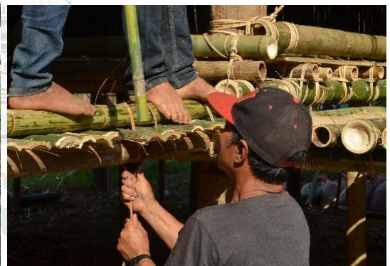
ขั้นตอนการติดตั้งไม้ขนานหลังฟากบริเวณพื้น
