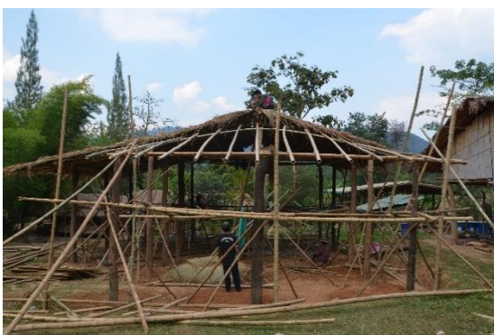
ขั้นตอนการเตรียมพื้นที่สำหรับมุงหลังคาบริเวณพะไล
