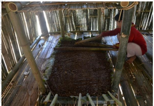
ขั้นตอนการอัดดินให้แน่นเพื่อใช้ทำเป็นฐานของเตาไฟ
