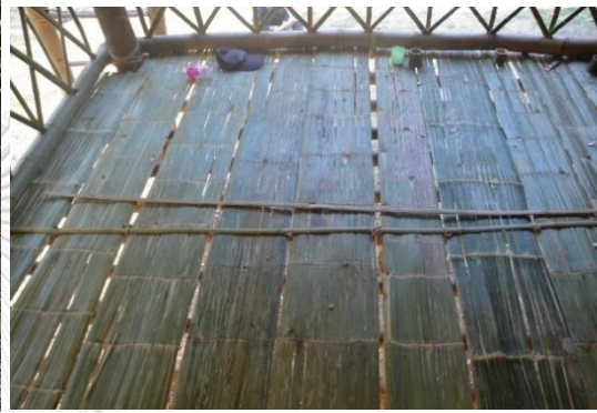
การหดตัวของพื้นฟากหลังจากการติดตั้ง 3 วัน
