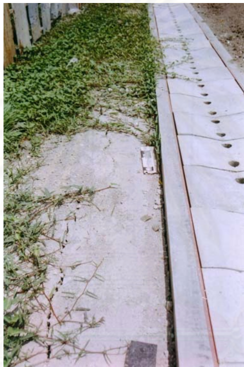
รูปที่ 4.19 รอยแยกด้านหลังโครงสร้างเสาดินซีเมนต์กันดินคลอง กม. 0+587.663
