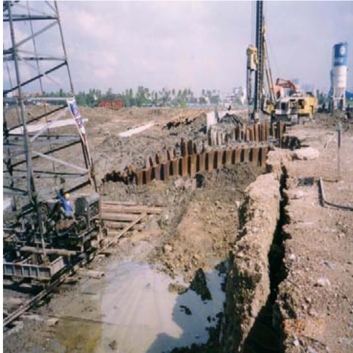
รูปที่ 4.4 แสดงการพังทลายของโครงสร้างกันดินฝั่งซ้ายในขั้นตอนงานขุดที่ระดับ -3.00 ม.รทก.
