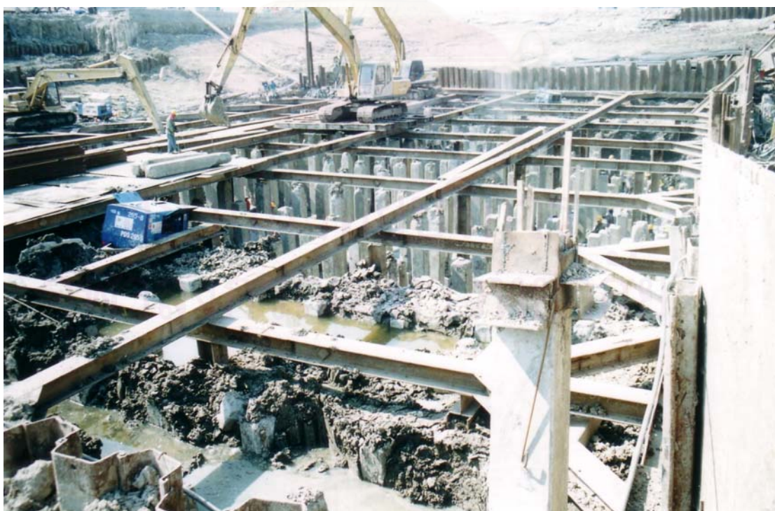
รูปที่ 3.34 แสดงงานขุดค้ำยันเพื่อเท Lean Concrete P2L และ P2M
