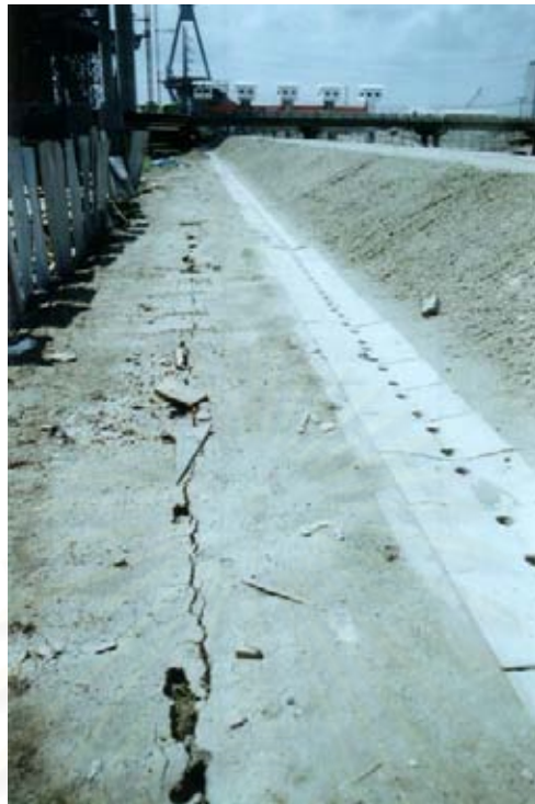
รูปที่ 4.20 รอยแยกด้านหลังโครงสร้างเสาคอนกรีตกั้นดินคลองขยายใหญ่ขึ้น
