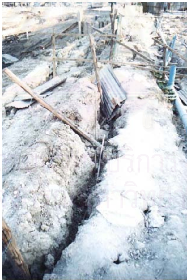
รูปที่ 4.5 แสดงการพังทลายของโครงสร้างกันดินฝั่งขวาในขั้นตอนงานขุดที่ระดับ -3.00 ม.รทก.
