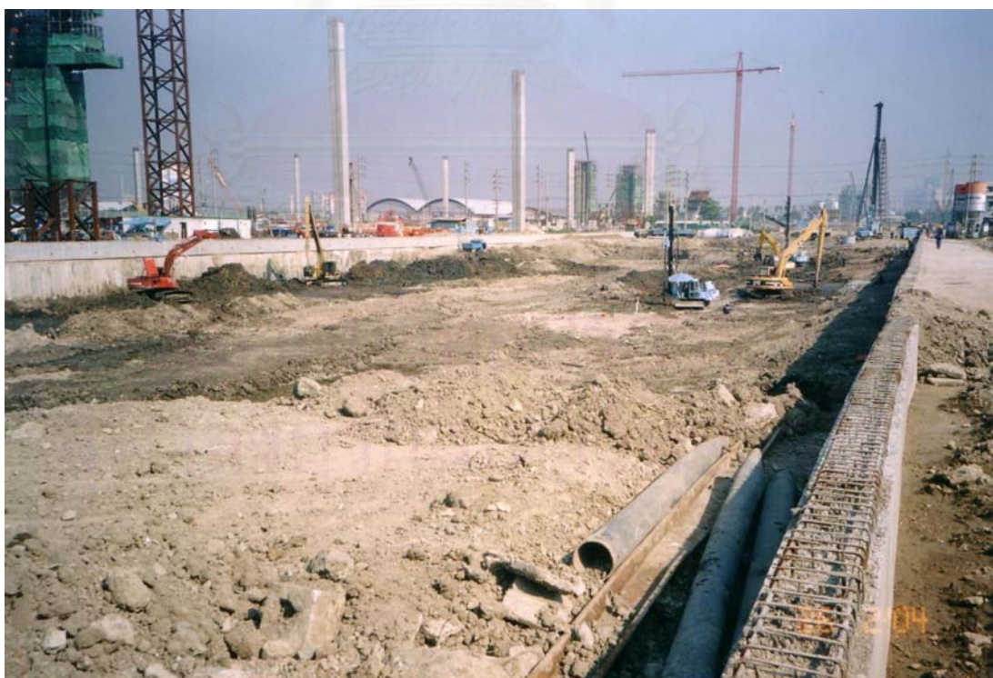
รูปที่ 3.44 แสดงงานขุดส่วนริมคลองถึงระดับ -3.00 ม.รทก. เพื่อก่อสร้างเสาหินซีเมนต์พื้น
