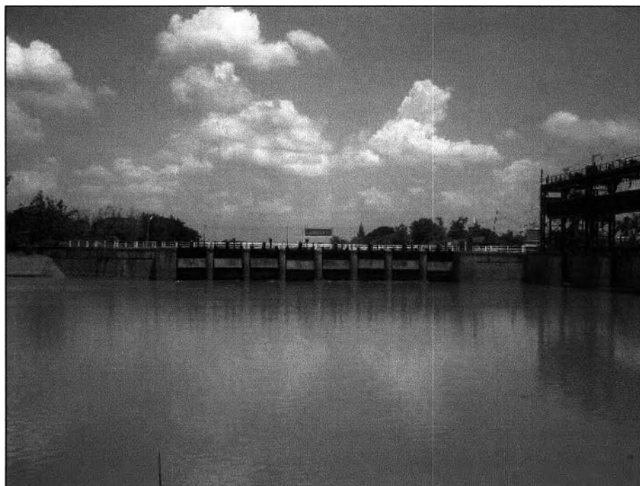
รูป ฉ-4 ปตร.พระนารายณ์รับน้ำเข้าสู่คลองระพีพัฒน์เพื่อส่งให้พื้นที่โครงการ เจ้าพระยาฝั่งตะวันออกตอนล่าง
