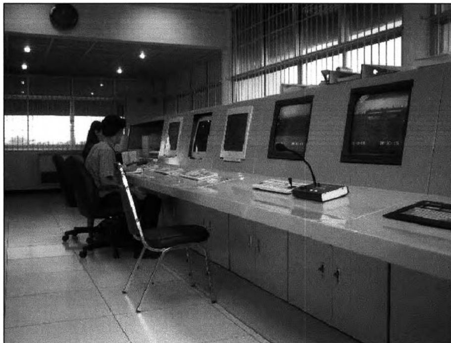
รูป ฉ-2 ห้องควบคุม(Control room) ของโครงการอ่างเก็บน้ำป่าสักฯ
