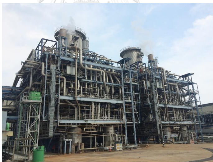
รูปที่ 1.5 หม้อกำเนิดไอน้ำ Heat Recovery Steam Generator
