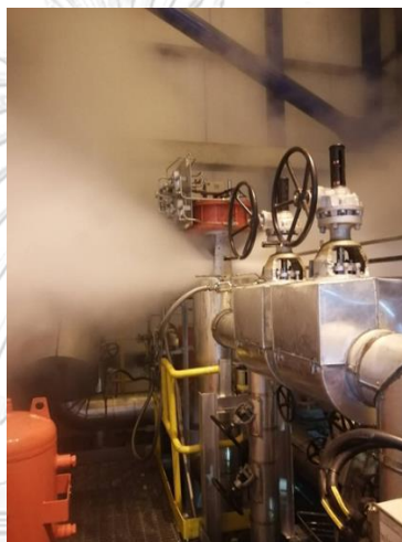
รูปที่ 2.24 วาล์วรั่ว (leak) สู่ภายนอก
