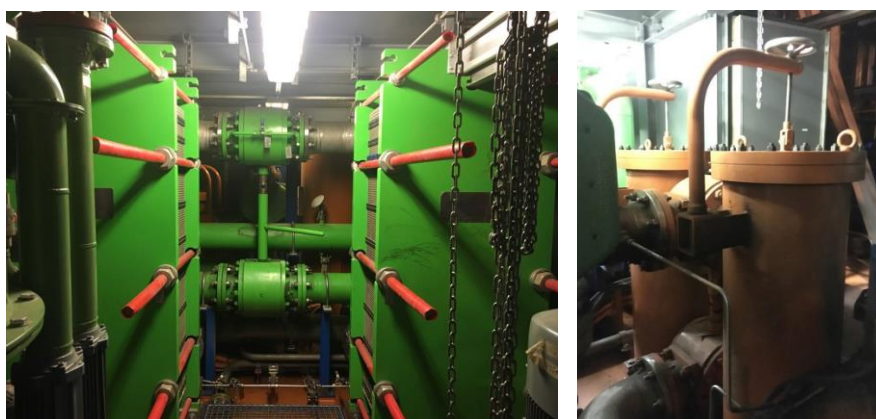
รูปที่ 2.4 เครื่องระบายความร้อนแบบแผ่น (Lube Oil Cooler)
