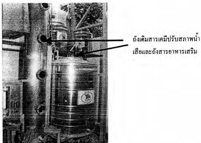
ภาพผนวกที่ 2 ถังเคมิสสารเคมีปรับสภาพน้ำเสีย ถังเคมิสสารอาหาร และ ถังปรับสภาพน้ำเสีย
