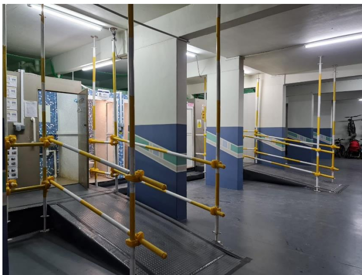
ภาพ 53 ห้องน้ำและห้องอาบน้ำชั่วคราวในชั้นล่างของอาคารที่กำลังถูกบูรณะ ที่มา: ผู้วิจัยถ่ายภาพจากสถานที่จริง ในปี พ.ศ. 2560
