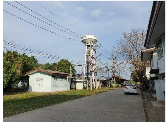
② งานระบบประปา
