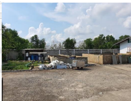
④ งานระบบบำบัดน้ำเสีย
