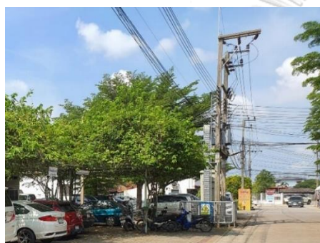
① งานระบบไฟฟ้า
