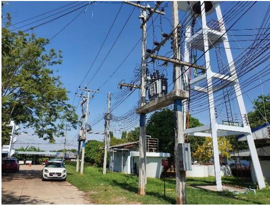
① งานระบบไฟฟ้า
