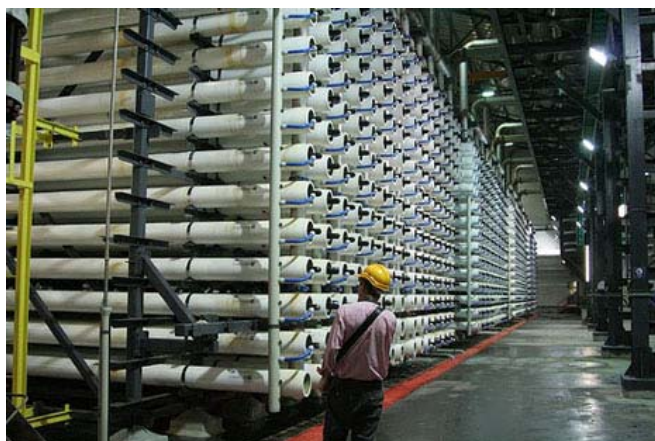
(2) ภาพภายในโรงงาน Desalination ใน Ashkelon, Israel
