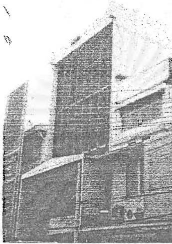
ภาพที่ 5 - 10 ห้างแก้วฟ้า หลังจากเกิดไฟไหม้ยังไม่มีการดำเนินการรื้อถอนอาคาร
