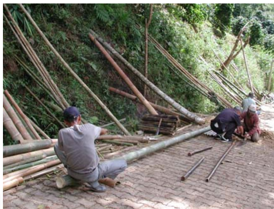
ภาพที่ 6.23 แสดงการทำโครงสร้างพาดช่วงกว้าง 12 ม.
