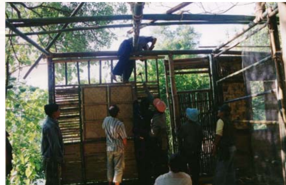
ภาพที่ 6.30 แสดงการติดตั้งผนังกับโครงสร้างหลัก
