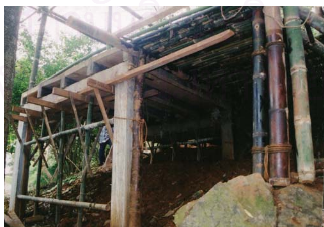
ภาพที่6.7 แสดงโครงสร้างคอนกรีตเสริมไม้ไผ่
