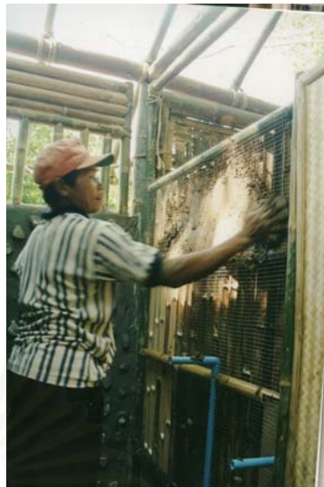
ภาพที่ 6.32 แสดงการฉาบดินซีเมนต์ลงในผนังไม้ไผ่
