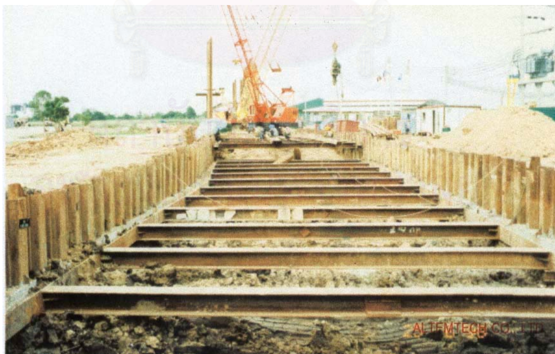
รูปที่ 3.24 แสดงการติดตั้งระบบกำแพงชั้นที่ 1
