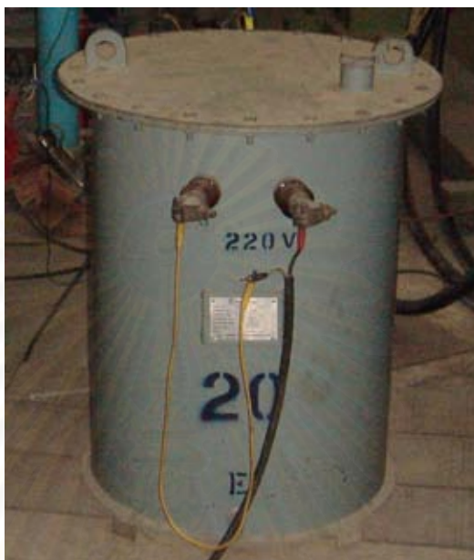
รูปที่3.21 หม้อแปลงจำหน่ายสำหรับจ่ายกำลังไฟฟ้า
