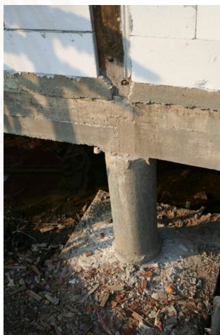
รูปที่ ข-42 แสดง รอยต่อระหว่างต่อม่อ คาน คสล. โดยมีเสาไม้ขนาด 15x15 ซม. ยึดติดกับ คาน คสล. และมีอิฐมวลเบาเป็นผนังก่อ
