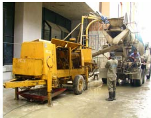
รูปที่ 6-100 แสดง รถผสมคอนกรีตสำเร็จรูป เป็นรถออกแบบมาเฉพาะ มีท่อที่สามารถหมุนเพื่อให้คอนกรีตผสมและผสมน้ำยาในเวลาไม่ให้คอนกรีตแข็งตัวก่อนกำหนด
