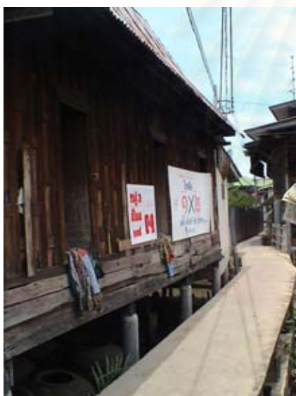
รูปที่ 5 – 25 ทักษะสภาพด้านข้างอาคาร ผนังไม้บางส่วนผุแล้วและเกิดช่องว่าง ผนังบางส่วนได้รับการซ่อมแซมด้วยการ นำเศษไม้หรือ ป้ายไม้อัดมีโฆษณามาตี ปิด
