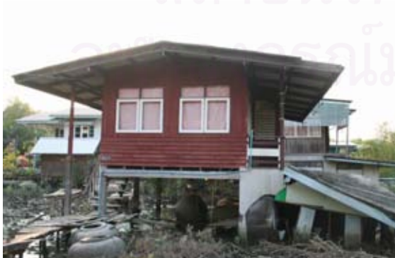
รูปที่ ข-39 แสดงอาคารพักอาศัย 2 ชั้นโครงสร้างไม้ ที่เกิด การทรุดตัวของโครงสร้างที่ไม่เท่ากัน
