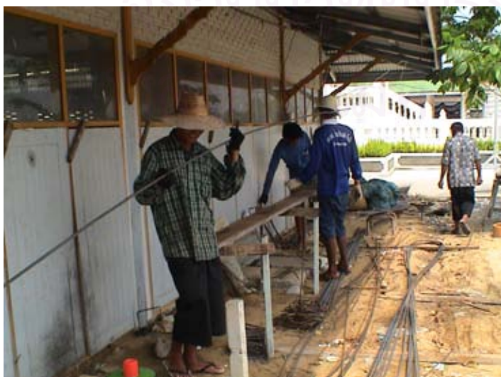
รูปที่ ข-12 แสดงการขึ้นโครงและผูกเหล็ก สำหรับโครงสร้างคอนกรีตเสริมเหล็ก โดยช่างชาติ ทองเปรม
