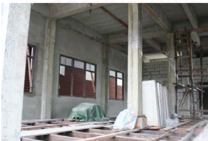
รูปที่ ข-15 แสดงโครงสร้างคอนกรีตเสริมเหล็ก แผ่นพื้นสำเร็จรูป และผนังก่ออิฐมวลเบา ในอาคารที่ช่างภิญโญ ร่วมก่อสร้าง
