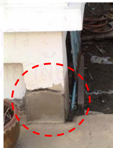
รูปที่ ข-40 แสดงอาคารพักอาศัย 2 ชั้นโครงสร้าง คอนกรีตเสริมเหล็ก การทรุดตัวที่ไม่เท่ากันของ โครงสร้างหลักกับโครงสร้างพื้นเฉลียงหน้าบ้าน
