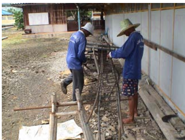
รูปที่ 6-44 แสดงการผูกเหล็กโครงสร้างคาน ต้องใช้ช่างที่อ่านแบบก่อสร้างได้และเข้าใจการผูกและทาบเหล็ก
