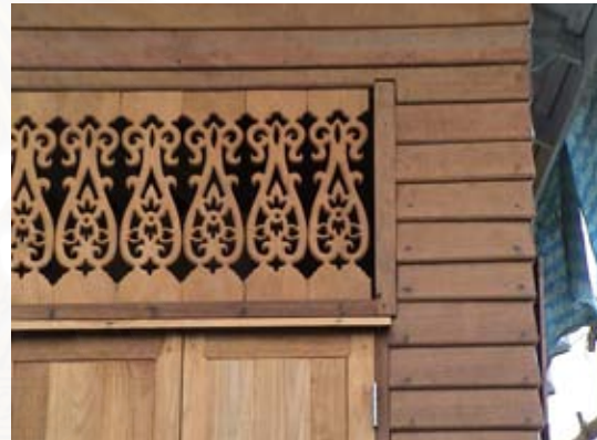
รูปที่ 6-80 แสดงองค์ประกอบอาคารที่ใช้ผลิตภัณฑไม้แปรรูปลักษณะต่างๆ เช่น ไม้กระดาน วงกบไม้บานประตูไม้ โดยใช้เทคโนโลยีระดับกลางในการผลิต
