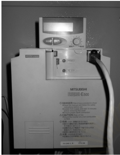
รูปที่ ง-10 ตัวปรับความเร็วมอเตอร์เครื่องสูบน้ำ
