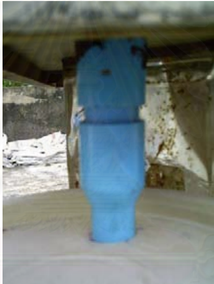
ภาพที่ 3.15 แสดงการต่อท่อระหว่างรูระบายน้ำและถังรองรับน้ำ
