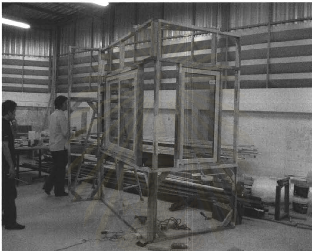
รูปที่ 3.6 แสดงการติดตั้งตัวแทนหน้าต่างมาตรฐาน
