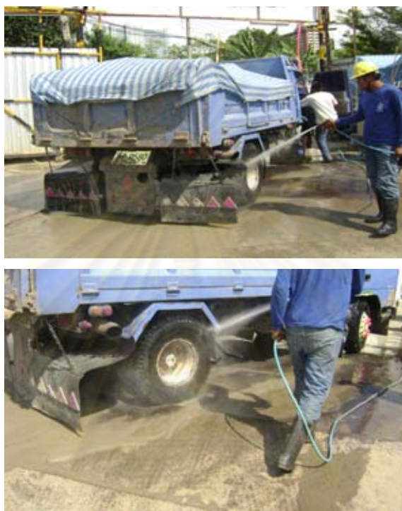
รูปที่ 4.34 แสดงจุดล้างล้อของโครงการก่อสร้างที่ 3
