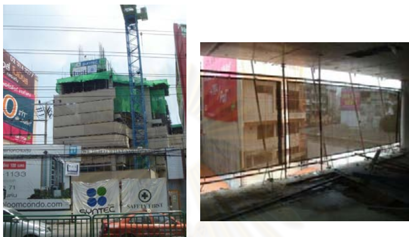
รูปที่ 4.6 แสดงการติดตั้งตาข่ายชนิดถี่โครงการก่อสร้างที่ 3
