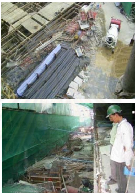
รูปที่ 4.27 แสดงการกองเก็บวัสดุของโครงการก่อสร้างที่ 1
