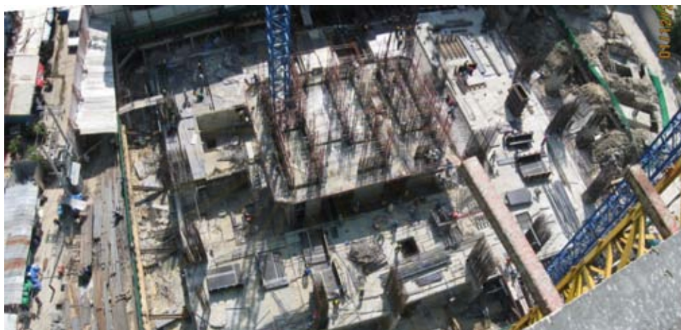
รูปที่ 4.17 แสดงพื้นที่ก่อสร้างของโครงการก่อสร้างที่ 2
