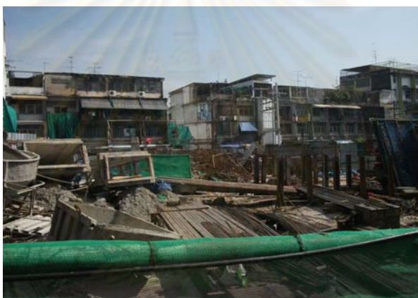
รูปที่ 4.28 แสดงกองเก็บวัสดุของโครงการก่อสร้างที่ 2
