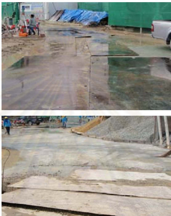
รูปที่ 4.37 แสดงการนำแผ่นเหล็กมาวางในพื้นที่ก่อสร้างของโครงการก่อสร้างที่ 1
