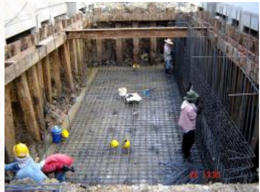
ภาพที่ 4.35 แสดงวางเหล็กพื้นและผนัง ถึงบ้ำบัดและถึงเก็บน้ำใต้ดิน
