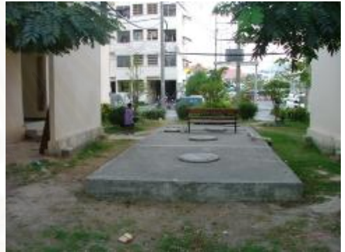
ภาพที่ 4.66 แสดงถังเก็บน้ำใต้ดิน
