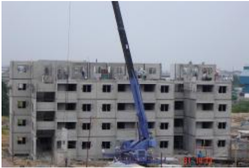
ภาพที่ 4.50 แสดงการติดตั้งชิ้นส่วน พื้นและผนังชั้น 5
