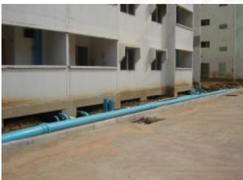
ภาพที่ 4.55 แสดงท่อน้ำรอบอาคาร
