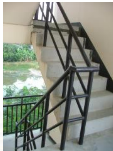
ภาพที่ 4.75 แสดงบันไดหนีไฟ ภายในอาคาร
