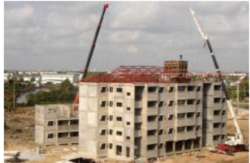
ภาพที่ 4.51 แสดงการติดตั้งถังเก็บน้ำ และหลังคา
