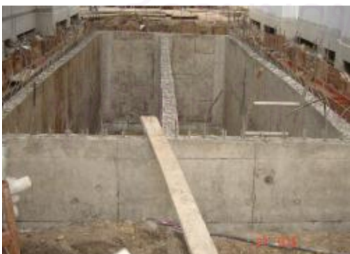
ภาพที่ 4.36 แสดงผนังถึงบ้ำบัดหรือ ถึงเก็บน้ำใต้ดิน
