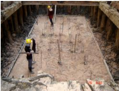
ภาพที่ 4.34 แสดงทำกำแพงกันดิน งานทำถึงบ้ำบัดและถึงเก็บน้ำใต้ดิน
