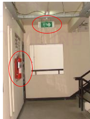
ภาพที่ 4.73 แสดงจุดติดตั้งถังดับเพลิง และป้ายบอกทางหนีไฟภายในอาคาร
