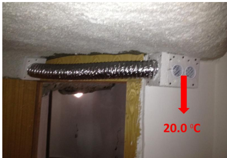
ภาพที่ 4.5 การวัดอุณหภูมิที่หัวจ่ายเครื่องปรับอากาศ
