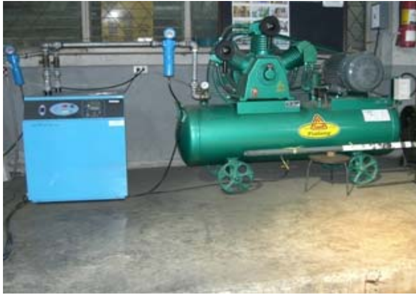
ภาพที่ 3.10 เครื่องอัดอากาศ พร้อมอุปกรณ์ทำความเย็นอากาศและระบบกำจัดน้ำในอากาศ
