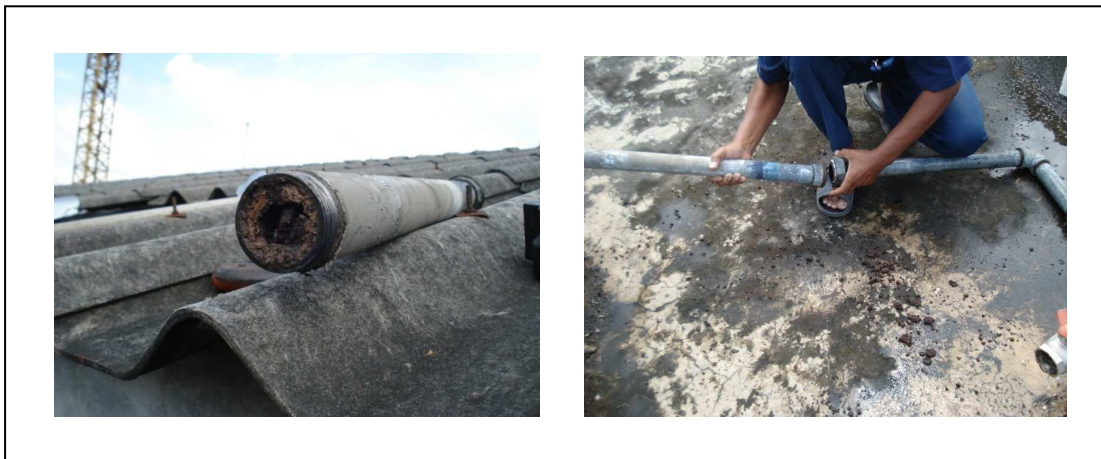
ภาพที่ 4.21 สภาพท่อน้ำดีตัน
