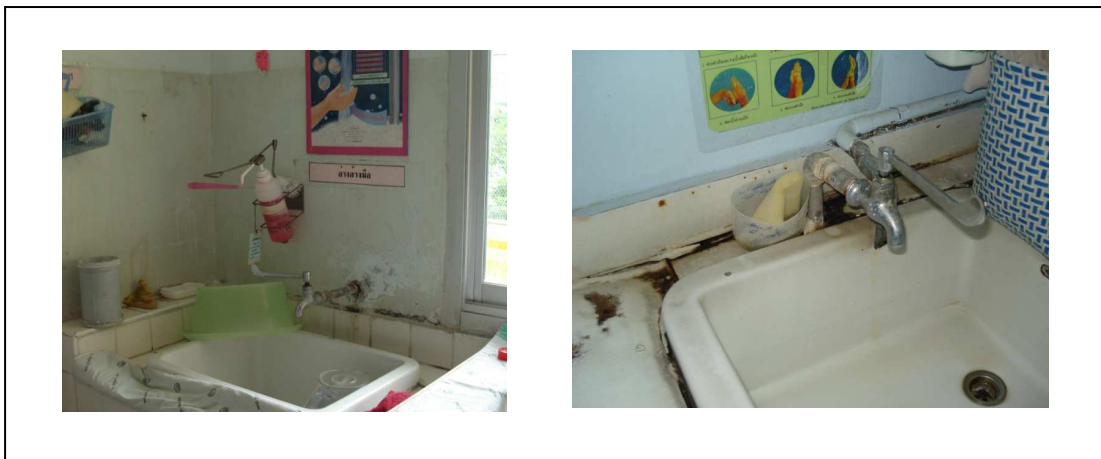
ภาพที่ 4.22 สภาพน้ำรั่วซึม
