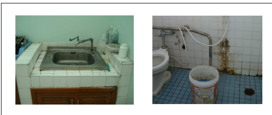
ภาพที่ 4.20 สภาพน้ำประปาไม่ไหล
