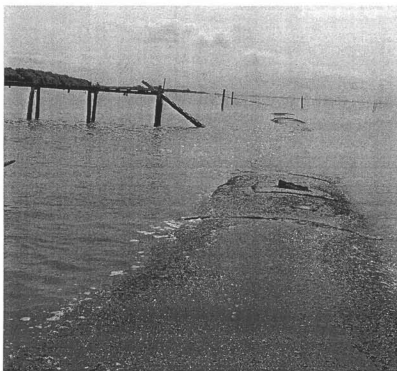
รูปที่ ฅ-4 แสดงการหลุดตัวของ Geotube สังกัดจากระดับน้ำทะเล
