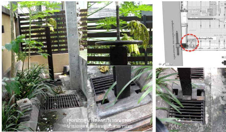
ภาพที่ 5.11 แสดงรูปภาพโครงการ ทรีคอนโดลาดพร้าว 27 ภายหลังก่อสร้างปี พ.ศ. 2554
