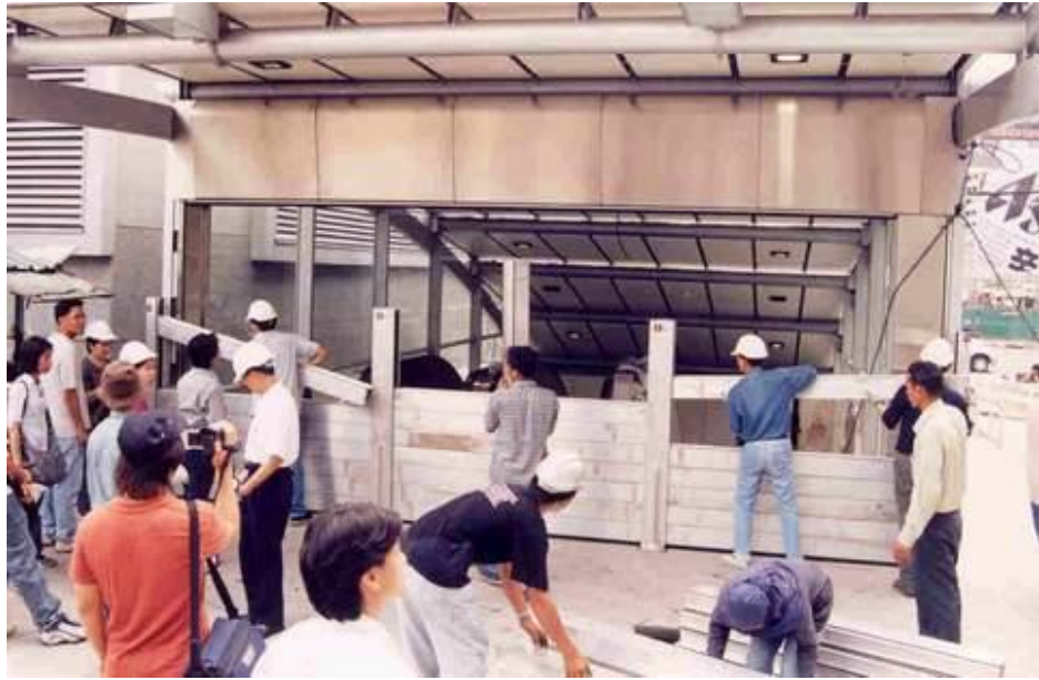
ภาพที่ 2.11 แสดงการติดตั้งแผ่นกันน้ำแบบถอดได้(Stop Log)ที่ลงทางสถานี รถไฟฟ้ามหานคร
