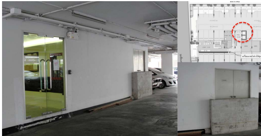
ภาพที่ 5.10 แสดงรูปภาพโครงการ ทรี คอนโดลาดพร้าว 27 ภายหลังก่อสร้างปี พ.ศ. 2554
