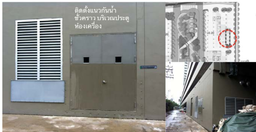
ภาพที่ 5.47 แสดงรูปภาพโครงการ ลุมพินีพาร์คปิ่นเกล้าภายหลังจากน้ำท่วมปี พ.ศ. 2554
