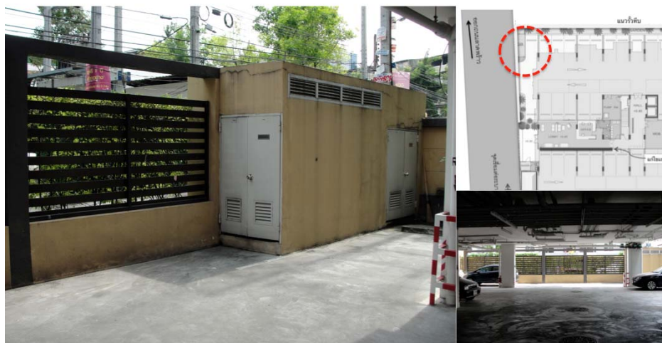
ภาพที่ 5.15 แสดงรูปภาพโครงการ ทรี คอนโดลาดพร้าว 27 ภายหลังจากท่วมปี พ.ศ. 2554
