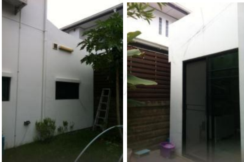
รูปภาพที่ 5.3 แสดงลักษณะการต่อเติมภายนอกและปัญหาที่เกิดจากการต่อเติม
