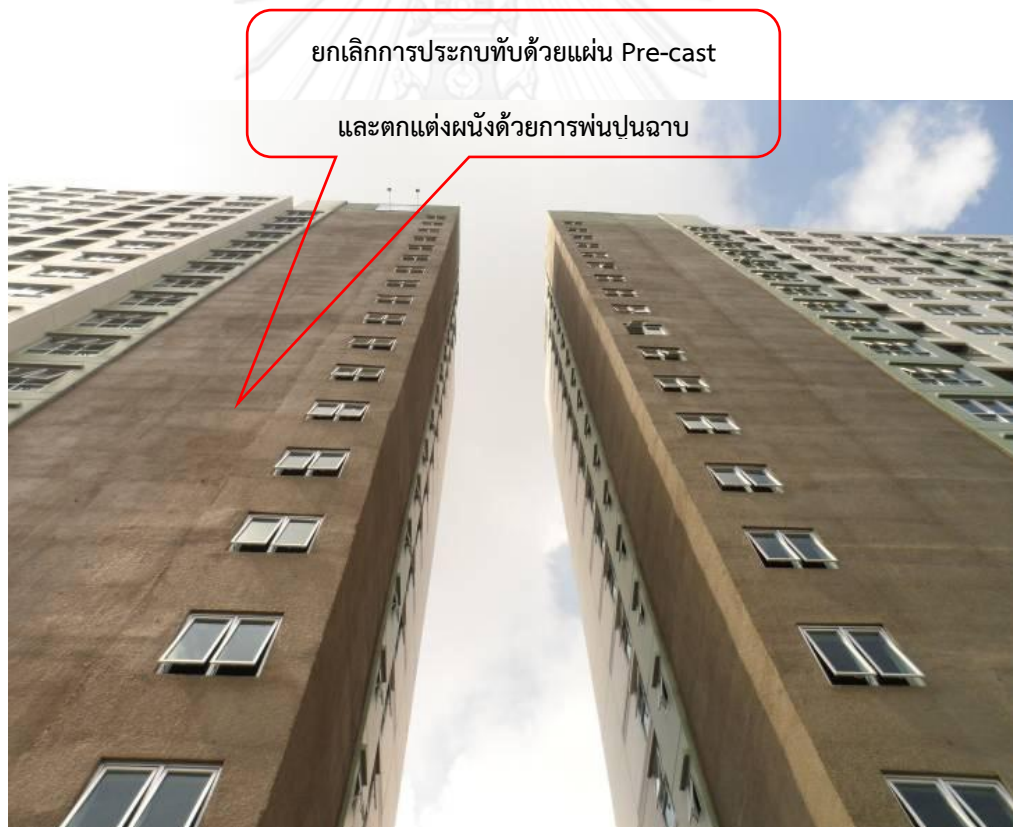
รูปภาพที่ 5- 23 ผนังภายนอกช่องลิฟท์ยกเลิกการประกบทับด้วยผนังสำเร็จรูประบบ (Pre-cast concrete) (จากตารางที่ 5-15)
