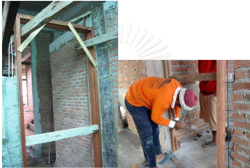
รูปภาพที่ 5- 1 รูปภาพตัวอย่างการติดตั้งวงกบระบบเปียกที่ต้องติดตั้งวงกบประตูก่อนมีการเทเสาเอ็นทับหลัง
